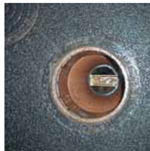
5 Rottespærren er nu monteret og kan nemt efterses og renses.
